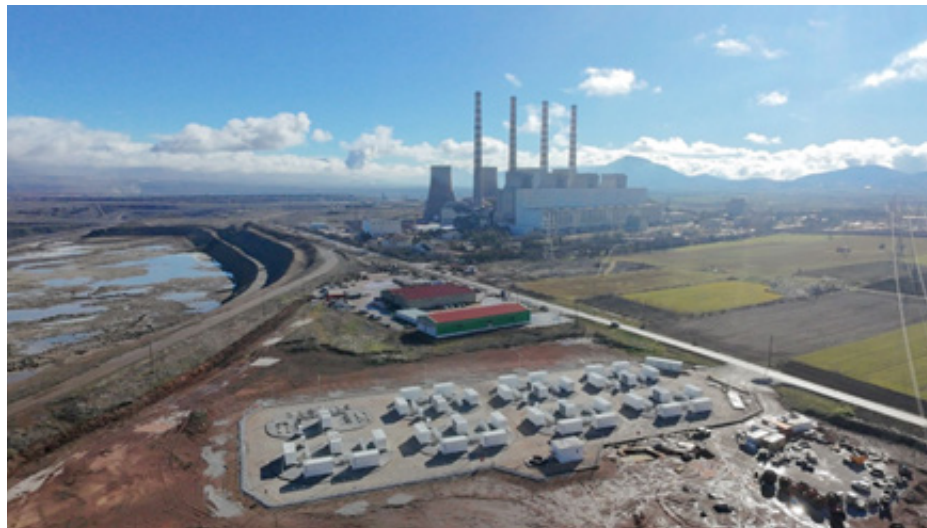
Συστοιχία συσσωρευτών του Σταθμού Ηλεκτροχημικής Αποθήκευσης Πτολεμαΐδας IV. Διακρίνεται ο ΑΗΣ Καρδιάς, αλλά και η θέση του κάτω ταμιευτήρα του μελλοντικού σταθμού αντλιοσταμίου.
